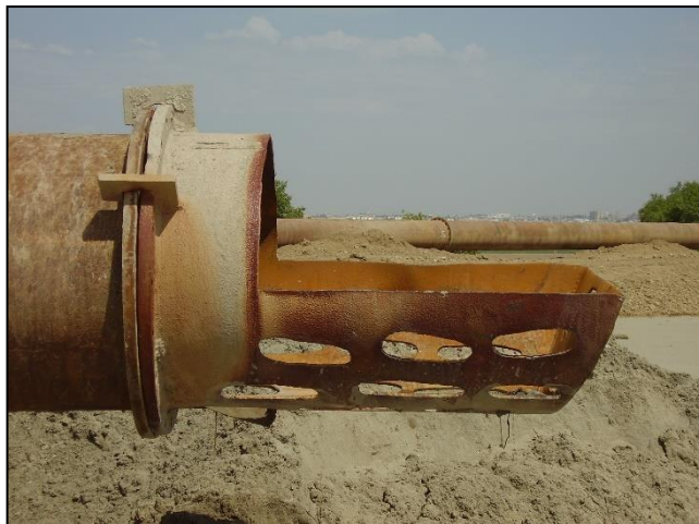
Ilustración 76. Filtro de retención de materiales colocado en la boca de salida de la tubería.
