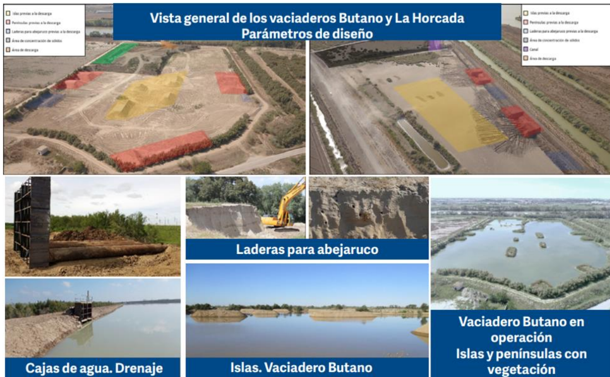
Ilustración 51. Secuencia de los trabajos realizados en los vaciaderos de Butano y La Horcada. Fuente: APS
